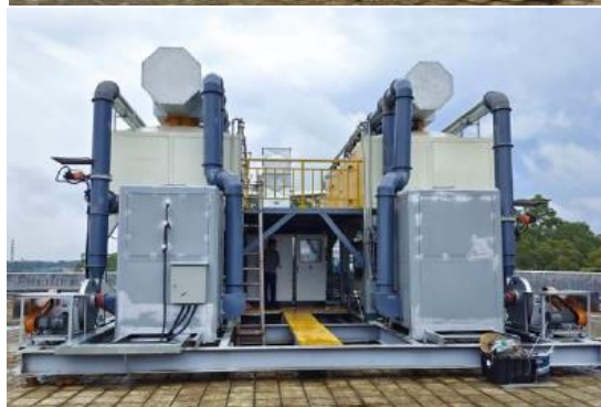
活性炭吸附濃縮及催化燃燒組合設備
